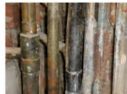
5 Typische Installation: Bleileitungen in älteren Gebäuden.
