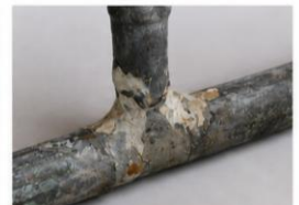
6 Abzweigung an alter Bleileitung.
