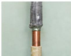
4 Im Rahmen einer zurückliegenden Teilsanierung wurde hier eine alte Bleileitung (oben) mit einer Kupferleitung (unten) verbunden.
